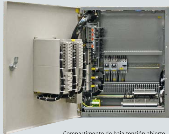
Compartimento de baja tensión abierto con equipos montados (opción)
